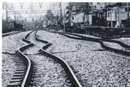
鉄道レールの座屈防止
